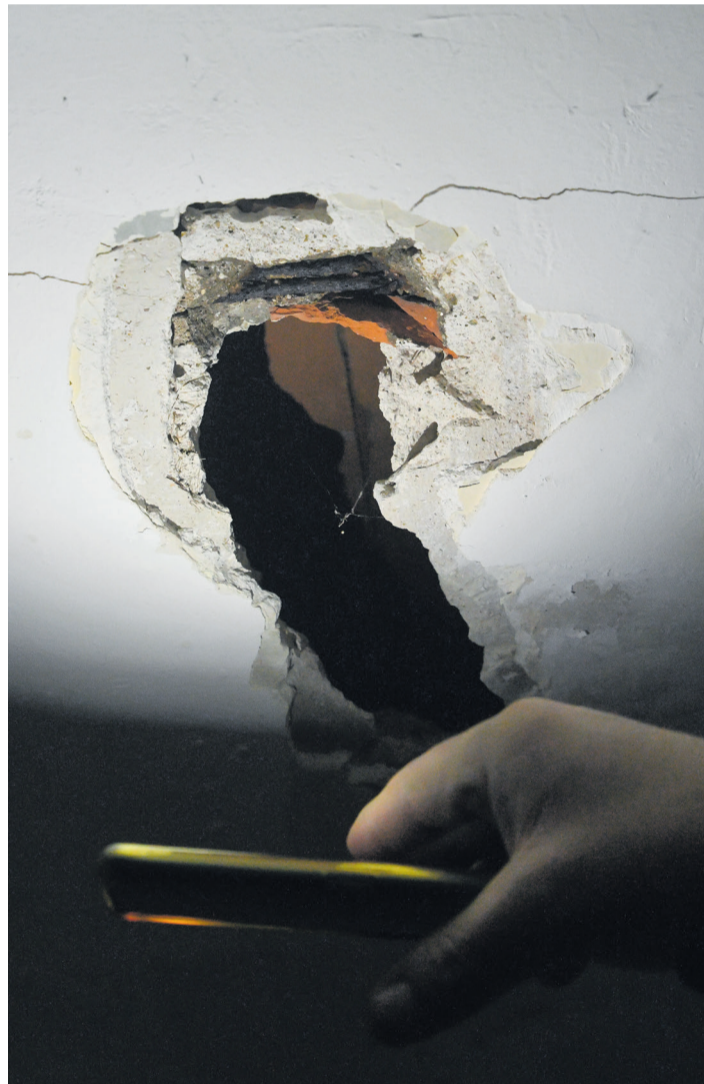
L'estat del sostre d'un dels habitatges dels Merinals en estudi / LL.F.
