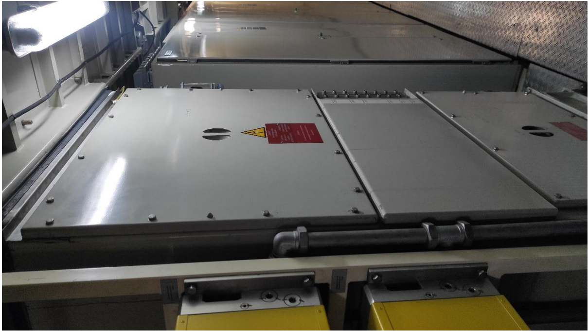
Εικόνα 5: Διάταξη εναλλάκτη θερμότητας, ψύξης υγρών Μετασχηματιστή (2 όμοιοι)
