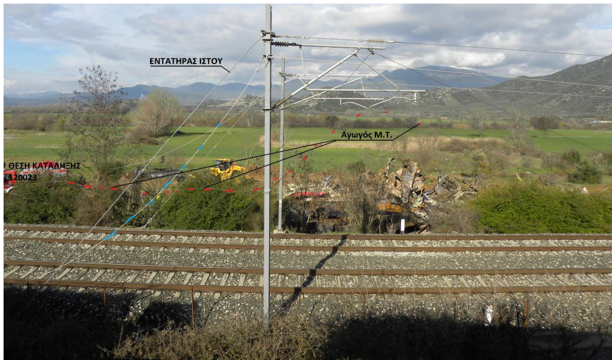
Εικόνα 17: Διασκορπισμός των αγωγών Μ.Τ. (25kV) των 2 κατευθύνσεων, στους τελευταίους πριν την αποκοπή ιστούς (2 ους μετά το τουνελ).
