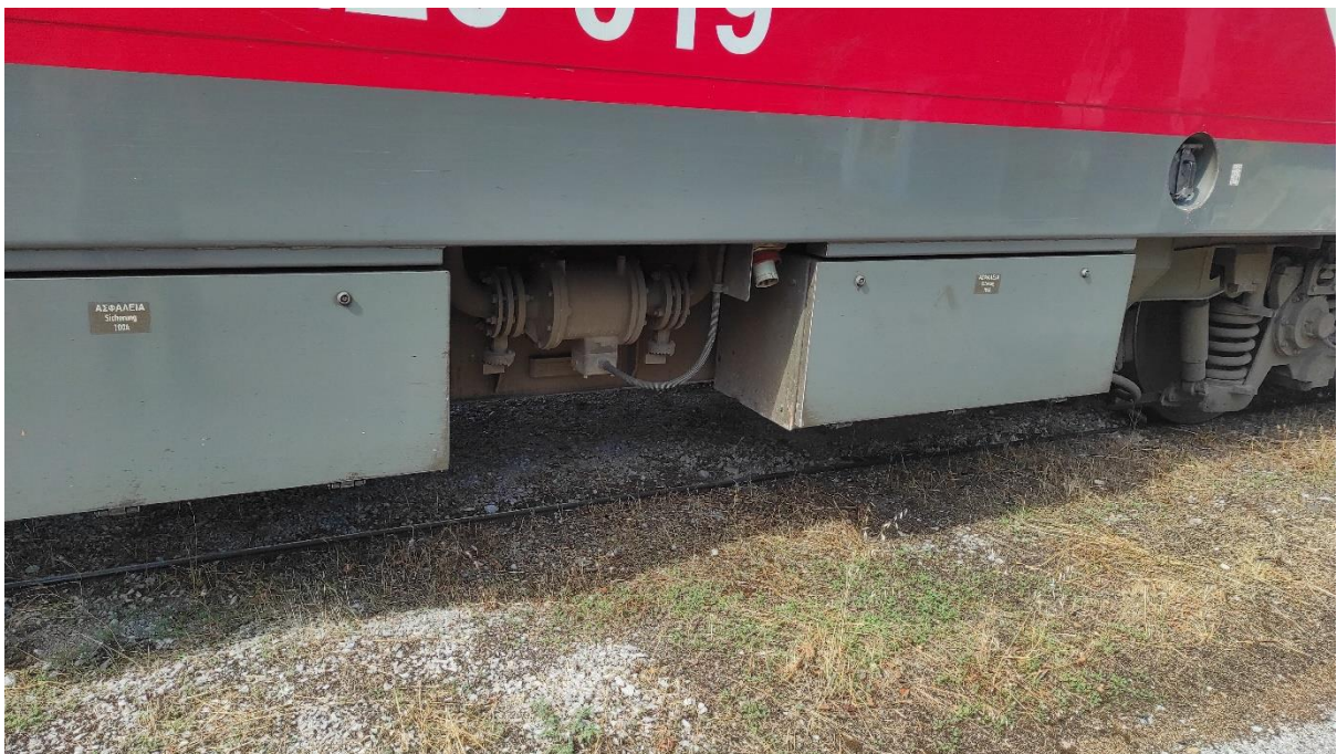
Εικόνα 10: 2 κουτιά μπαταριών της ηλεκτράμαξας. Ενδιάμεσα διακρίνεται η μία αντλία σιλικονούχου ψυκτικού υγρού του Μετασχηματιστή, προς το κύκλωμα ψύξης του.
