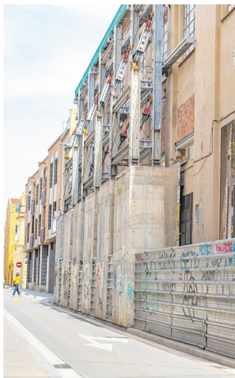
Estabilitzadors i tanques metàl·liques als carrers d'Alemanya i de Ferran Casablanques / AINATORRES
